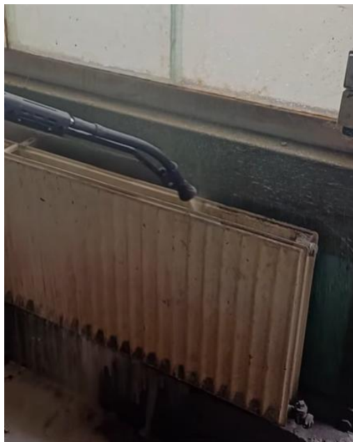
Flach-Heizkörper vorher (mit Reinigung zwischen den Platten)
