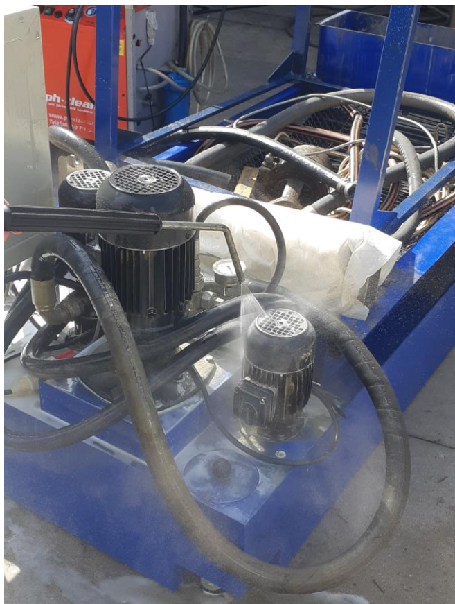
Reinigung Elektromotoren für die Kühlung von KSS: Reinigung mit KSS, wenn Werkzeugmaschine im Betrieb ist, oder mit Wasser und niedrig dosiertem alkalischen Reiniger
